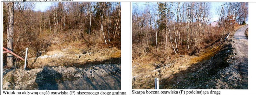
Widok na aktywną część osuwiska (P) niszczącego drogę gminną
